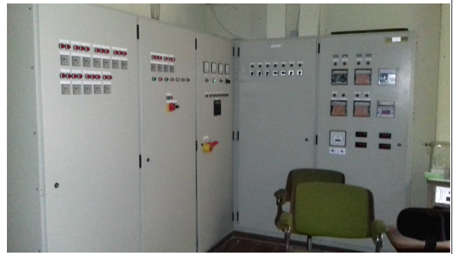
A: Wiegemeister / Registratur / Kontrollraum
